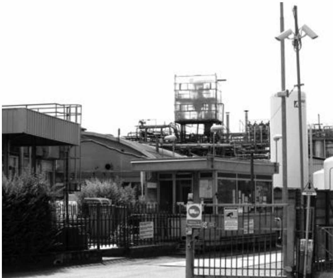
Lavori in corso alla Baerlocher di via San Colombano: i tecnici stanno ricostruendo il reparto liquidi, esploso a gennaio
