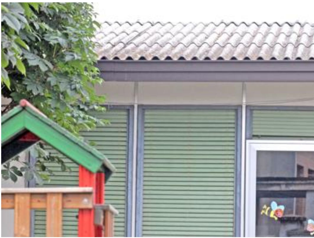
Il tetto in eternit della materna Giardino di via delle Orfane: per ora non è pericoloso ma il comune sposterà la scuola
